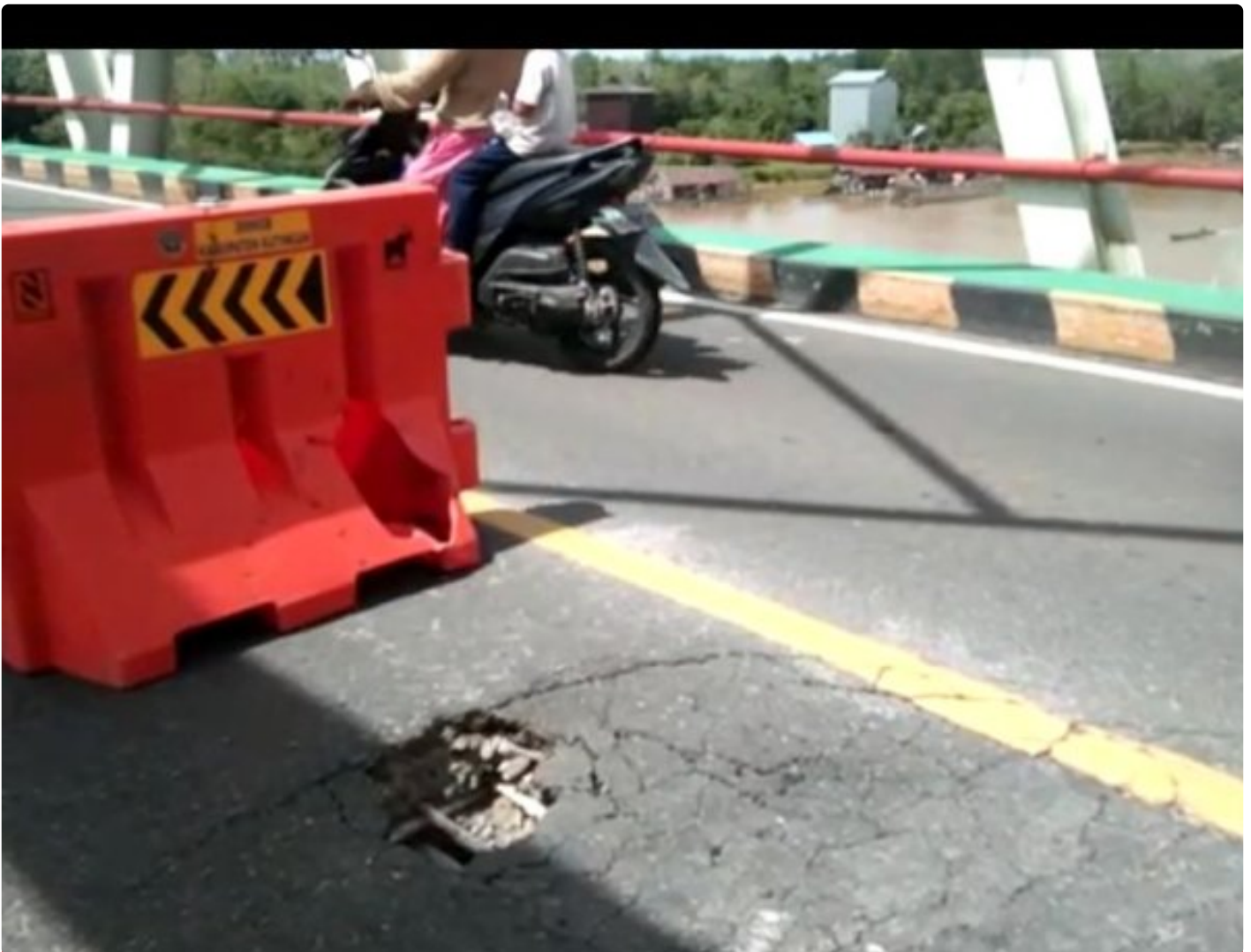
Gambar: Kondisi Jembatan Sei Katingan/Kasongan Yang Berlobang dan retak
